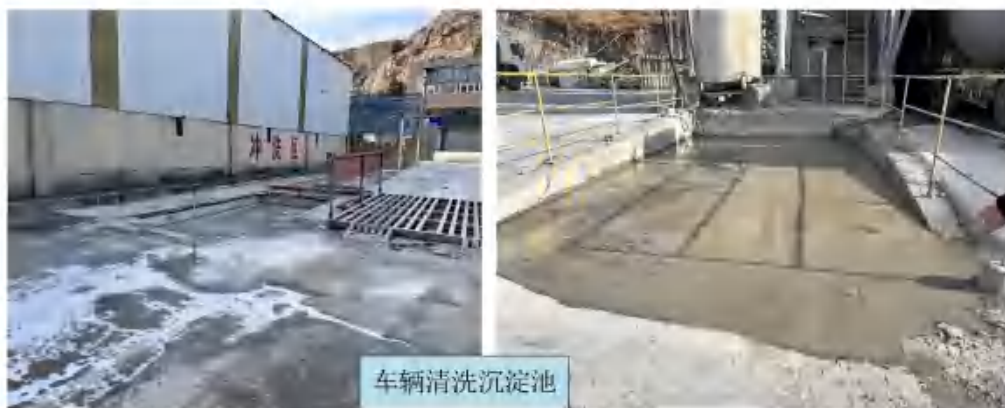
图 3-3 项目沉淀池照片
