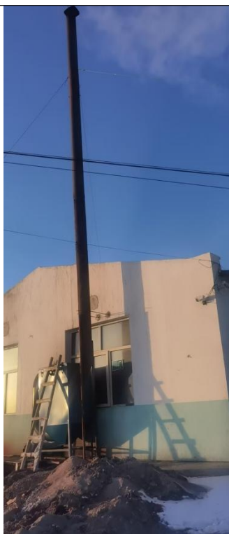
布袋除尘器+25米锅炉废气排放口
